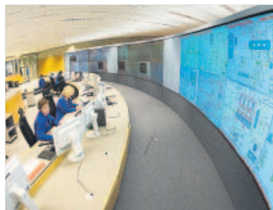
Alles im Blick: Leitstandmitarbeiter des Vattenfall Kraftwerkes Boxberg kontrollieren die Leistung und Funktion der Kraftwerke einschließlich des neuen 675-MW-Kraftwerksblocks.
